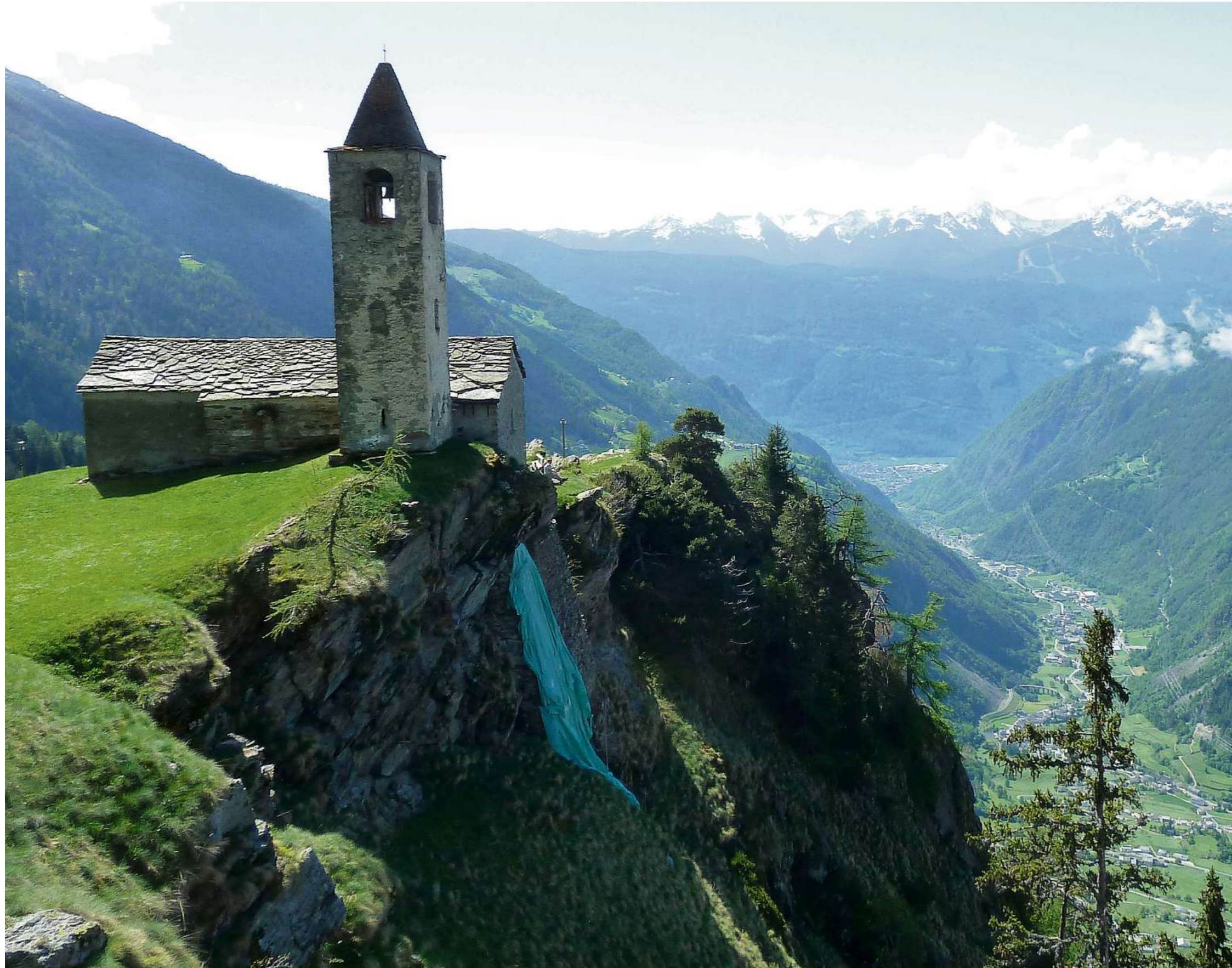
Renovationsbedarf: Eine Plane schützt provisorisch San Romerios Stützmauer; im Hintergrund Tirano.
